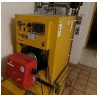
Beispiel alte Ölheizung
